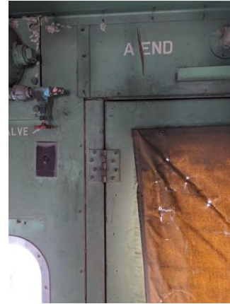
CHE-SP4641-130721-019 thru 021, 10% Asbestos, Gray door sealant
