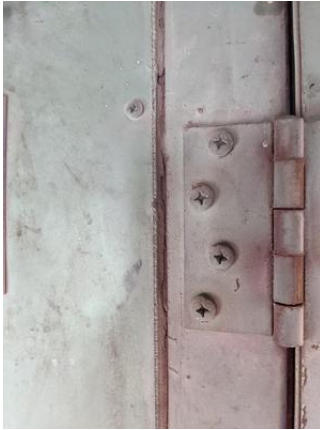
CHE-SP4641-130721-019 thru 021, 10% Asbestos, Gray door sealant
