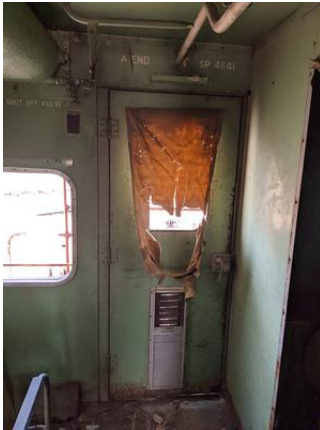
CHE-SP4641-130721-019 thru 021, 10% Asbestos, Gray door sealant
